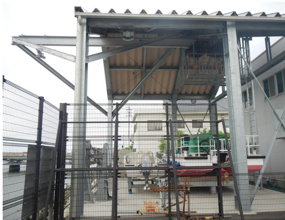
天井クレーン全景
